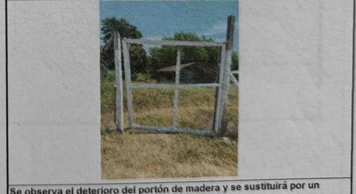
Se observa el deterioro del portón de madera y se sustituirá por un portón de metal.
