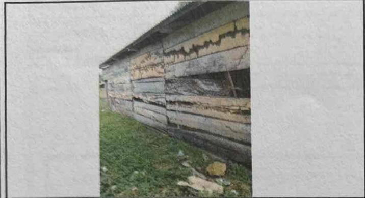
Se observa el deterioro de las paredes de tabla de la cocina y se sustituirá por block
