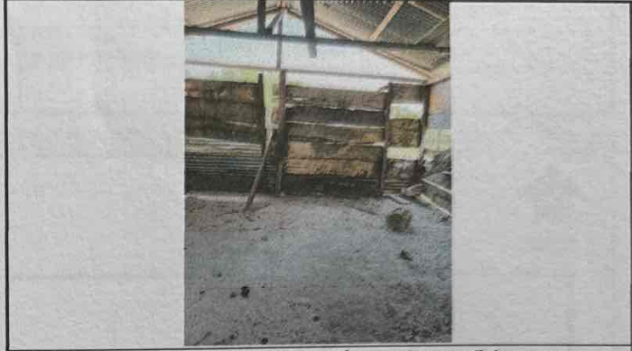
Se observa que el piso de la cocina está en malas condiciones y se sustituirá por piso liso.
